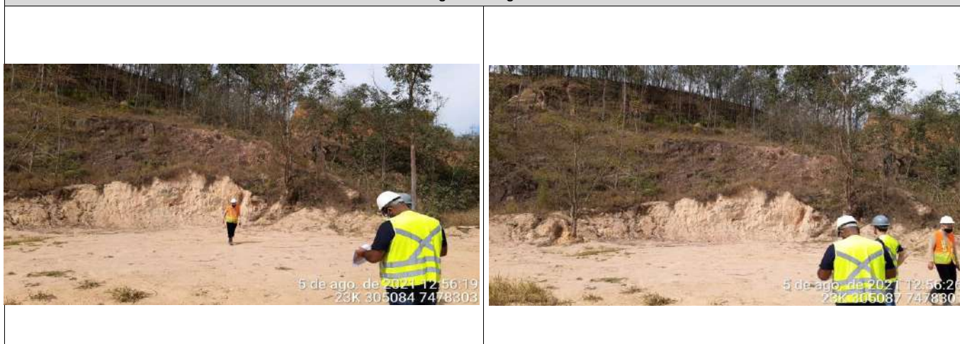
Foto 01 Vista geral do talude. Foto 02 Corte recente no talude expondo ainda mais as feições erosivas.
