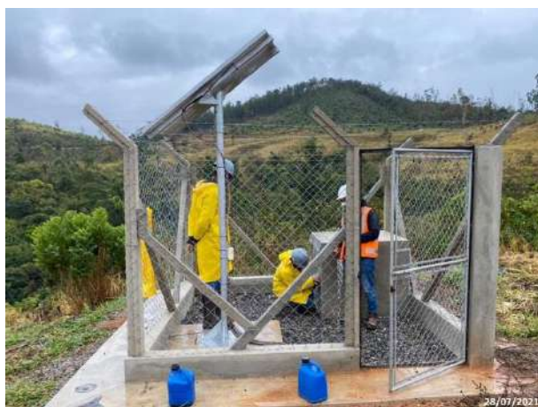
Foto 1 – Vistoria para verificação dos equipamentos. (Data: 28/07/2021).
